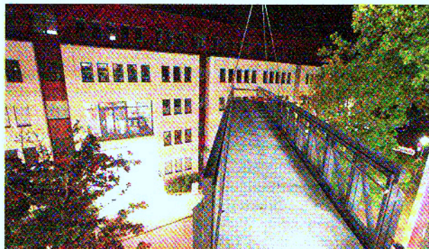
Zentimeter für Zentimeter wurde die Fußgängerbrücke über der Bergstraße eingeschwenkt und montiert. Foto: privat
