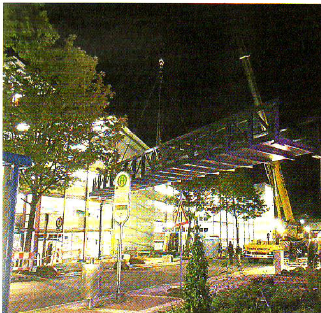
Ein Spezialkran manövrierte die neue Verbindungsbrücke zwischen dem Gesundheitszentrum Bochum und dem Parkhaus der Augusta-Kranken-Anstalt,.
